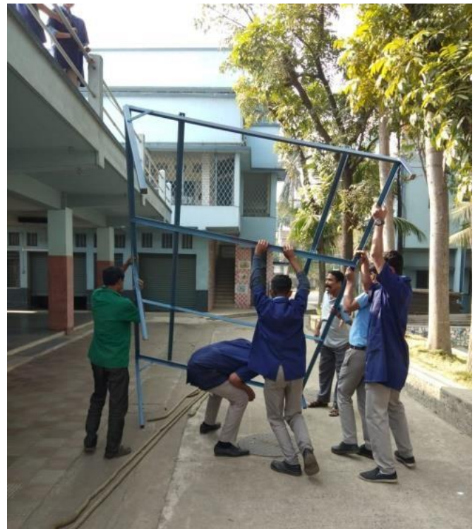
Structure portante pour les panneaux photovoltaïques
