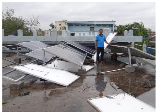
C'est la belle installation décrite par Adrien après le passage du cyclone.
