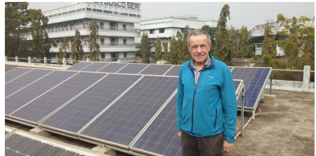
Installation solaire photovoltaïque de don Bosco avant le cyclone « Amphan »
