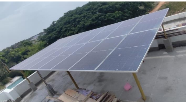
Figure 4 : Installation photovoltaïque de 10kW sur la toiture qui fait de l'ombre et permet ainsi de profiter de la terrasse quand il y a du soleil.
