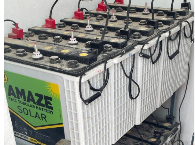
Figure 5 : Batteries qui permettent d'augmenter l'autoconsommation et de fournir de l'électricité aussi en cas de coupure d'électricité.
